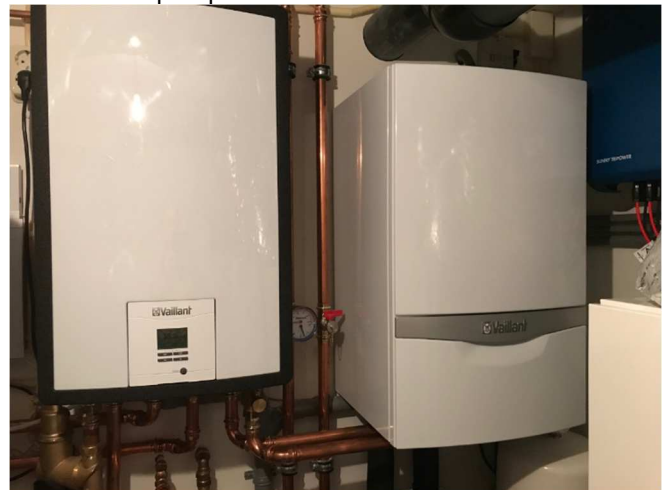
Valliant warmtepomp (boilervat staat er nog naast)
