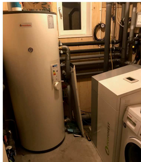
Ecoforest Warmtepomp met boilervat van 280 liter.
